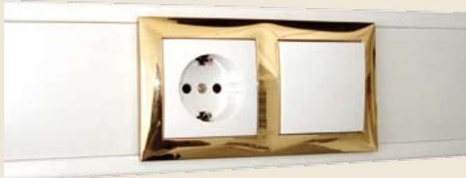
Розетка с заземляющими контактами и одноклавишный выключатель в двойной рамке в кабель-канале
