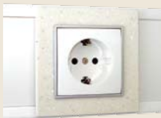
Розетка с заземляющими контактами в кабель-канале
